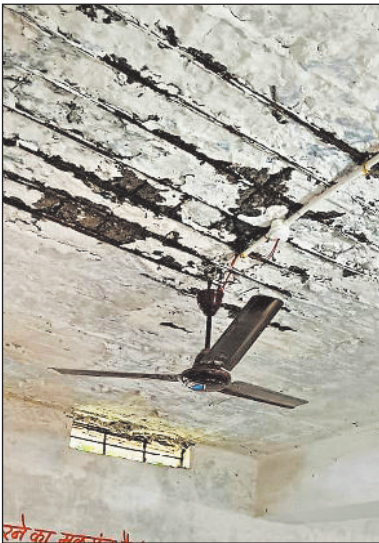
लटिया के स्कूल भवन की जर्जर हालत।
